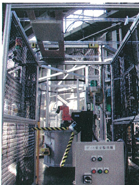
写真3-1 試作したカウンターゲートの外観
