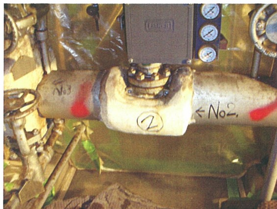
写真 4.2 水練り保温材が使用されている弁
