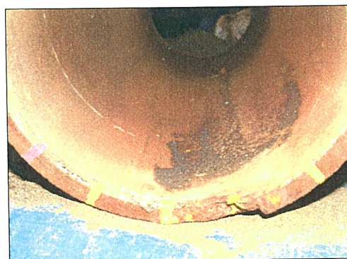
② ダクタイル铸铁管内面
