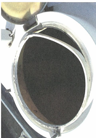
5-21改善前 ハッキンの硬化による密閉不良
