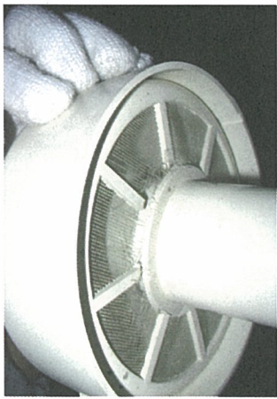
7-15改善前 防虫網の破損
