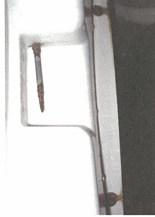
5-5改善前 蝶番軸の腐食、破損
