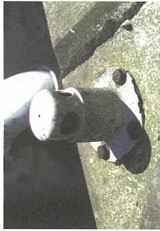
7-6改善前 通気管破損
