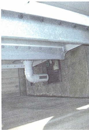
8-1改善前 管端部が排水溝へ直接連結
