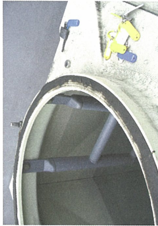
5-19改善前 ハッキンの劣化
