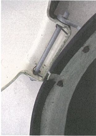
5-22改善前 ハッキン欠落
