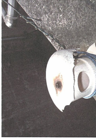
7-5改善前 通気管破損
