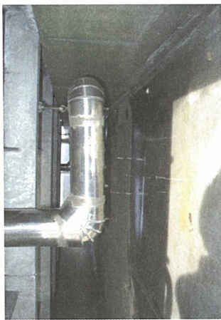
9-4改善前 給水管からの漏水
