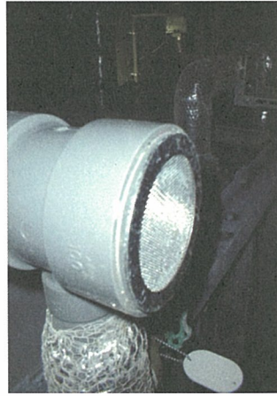
6-10改善後 正常な防虫網の取り付け
