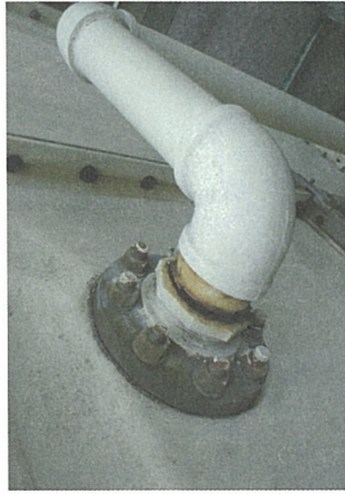
6-5改善前 管接合部の腐食
