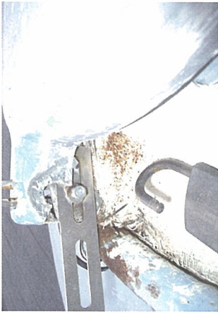
5-14改善前 施錠部の破損
