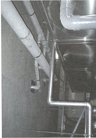
3-5改善前 水槽上部に汚水管
