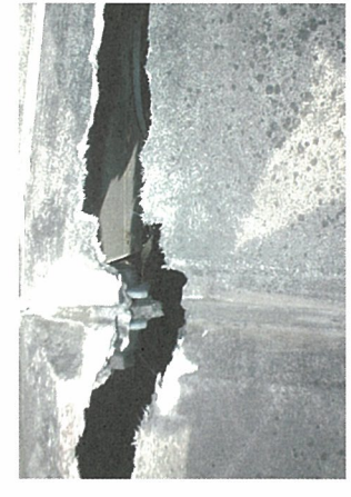
2-23改善前 本体破損
