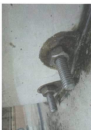
2-9改善前 ボルト取り付け部の隙間
