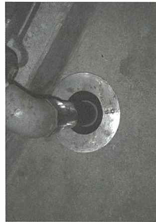
2-18改善前 揚水管挿入部が開放
