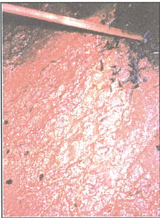
4-26改善前 錆発生
