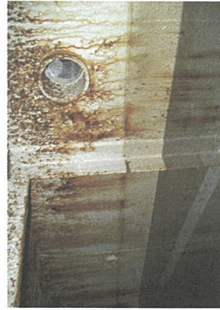
4-10改善前 内部の腐食
