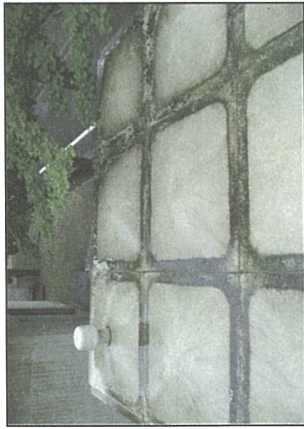
3-1改善前 水槽上部にたまり水あり
