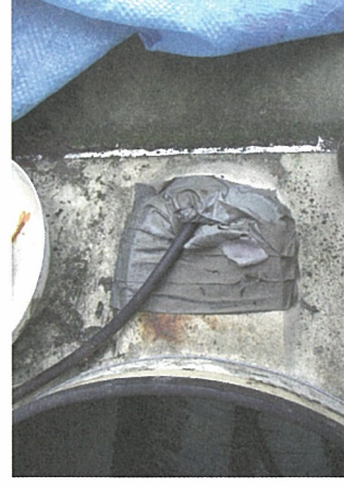
2-21改善前 コード等の挿入部の隙間
