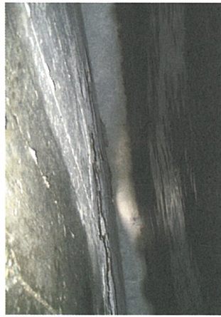
4-14改善前 RC水槽の壁面等の劣化
