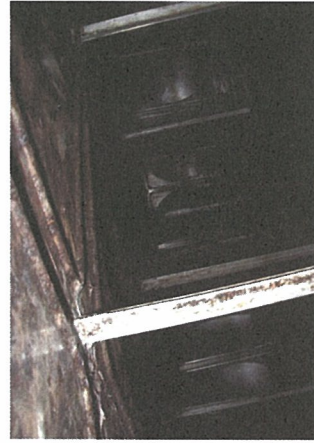
4-9改善前 内部の腐食
