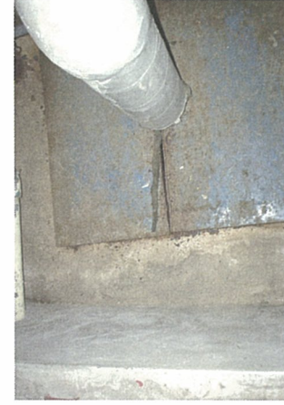
2-19改善前 揚水管挿入部の隙間
