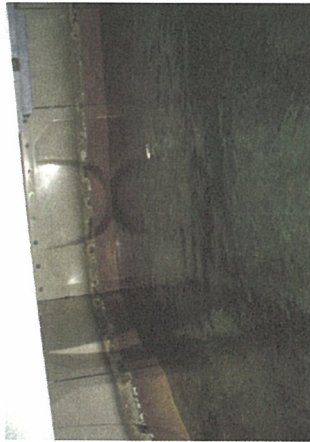
4-1改善前 水槽内部の汚れ
