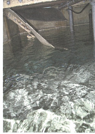
4-7改善前 内部構造物の破損(内部ハネル)
