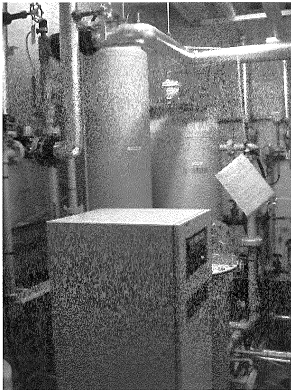
写真 1.3.5 施設 K のオゾン消毒装置
