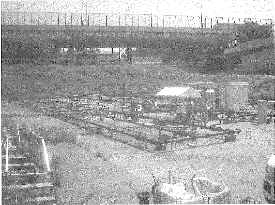
写真 7.3.1 実験配管全景
