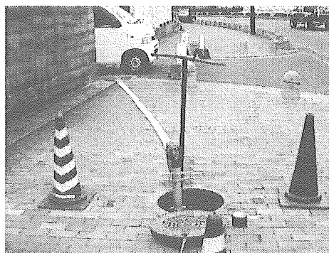
写真 7.2.38 下水マンホールへの放流
