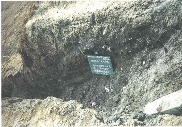
写真-5 現場浸透水出現位置 (上段部中間)
